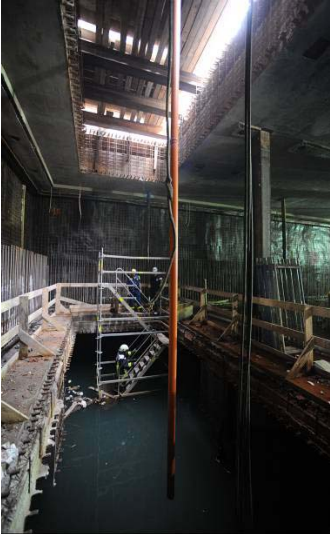
Blick in den U-Bahn-Schacht an der Unglücksstelle Severinstraße: Der "Keller" unter Ebene 2 steht noch immer unter Wasser. (Bild: Worrying)
